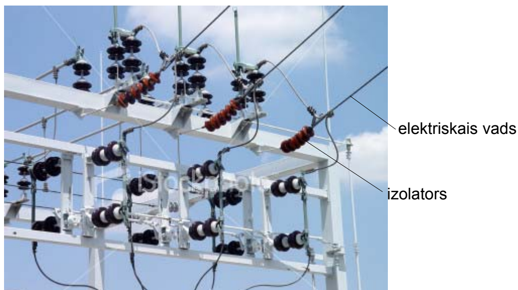
6.1.5. att. Augstsprieguma vadi un izolātori
